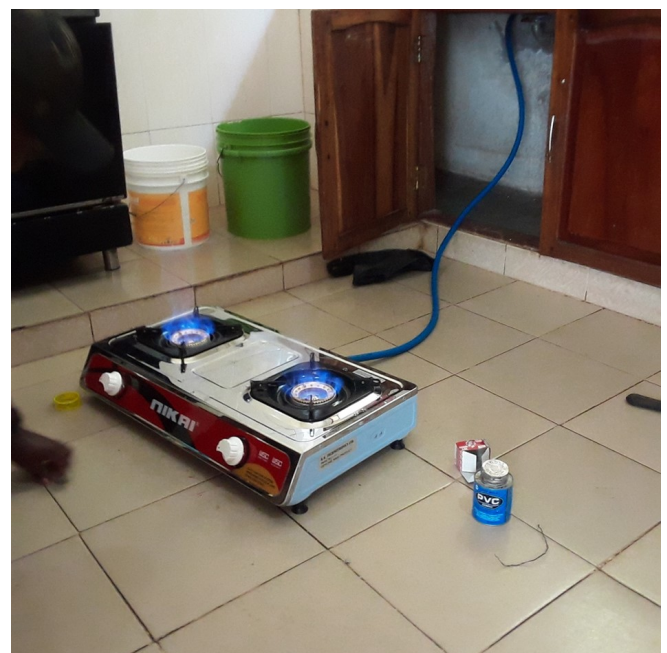
Le premier produit de biogaz testé et prêt à être utilisé pour la première fois dans la maison des pères avant d'être également acheminé vers la cuisine des étudiants .
